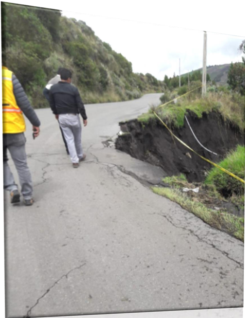
Gestión en el GADPCH para atención de la emergencia en la vía principal sector Cochapamba
